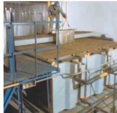
CESL Plant, Vancouver, B.C.
